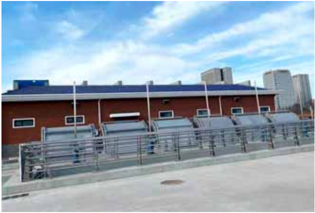
陈塘排水泵站
