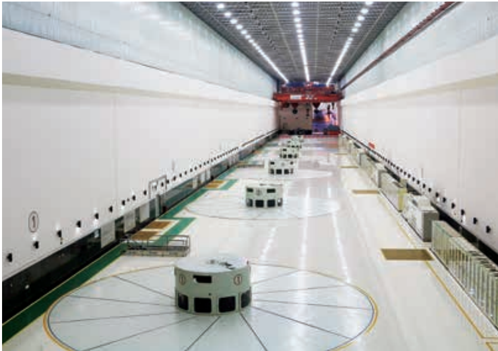
安装有6台单机700MW混流式机组的地下厂房
